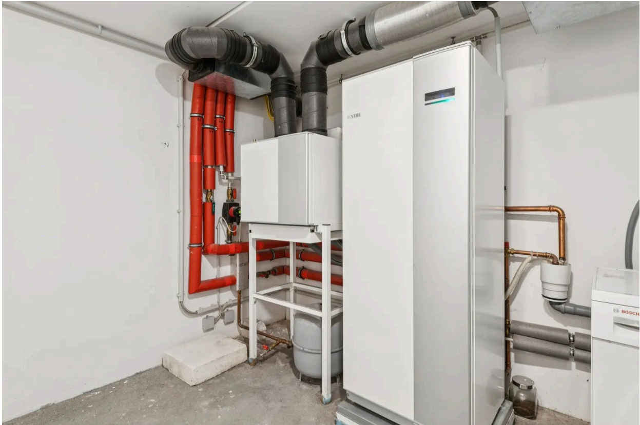
Heizung und Lüftung
